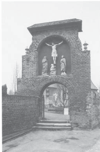
Esch bei Köln, Kreuzigungsgruppe. Die schützende Kopie: Die Originalgruppe aus extrem anfälligem Tuffstein konnte in das nahe Kircheninnere gebracht werden, nachdem im Friedhofstor eine Kopie aufgestellt wurde.
